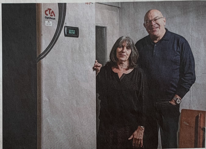
Angelina und Manfred Zimmermann vor der neuen Wärmepumpe. Sie ersetzt den Ölkessel und den Boiler und ist damit sogar noch platzsparend. Foto: Raphael Moser
